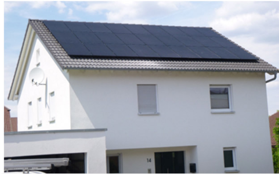
Vorbildliche Nutzung der Dachfläche für die eigene Stromernte aus Sonnenenergie
